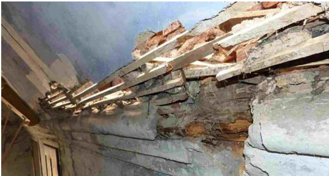
Ein Bild aus der Vergangenheit. Die Decke zeigte deutliche Schäden, zum Teil war schon der Putz heruntergefallen.
